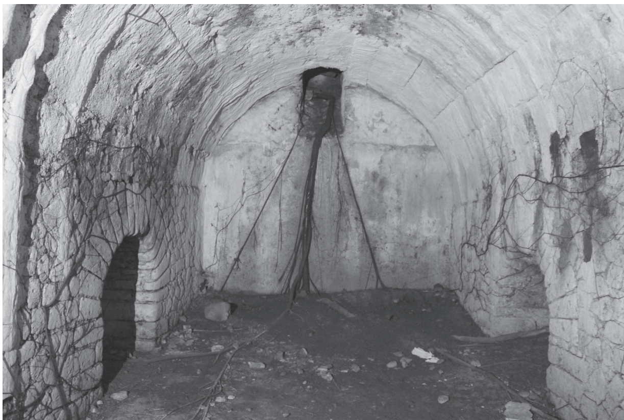
Fig. 34. Camigliano, cisterne in località Colonne Spezzate: muro di chiusura occidentale della quinta camera. In evidenza: finestra a bocca di lupo funzionale all'ingresso delle acque e radici infiltrate nella struttura.
